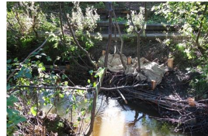
Travaux d'aménagement effectués sur les berges du ruisseau Bois-Joli par le Jardin Communautaire du ruisseau Bois-Joli
