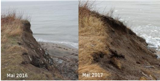
Comparaison temporelle de l'évolution de l'érosion du talus du dépotoir
