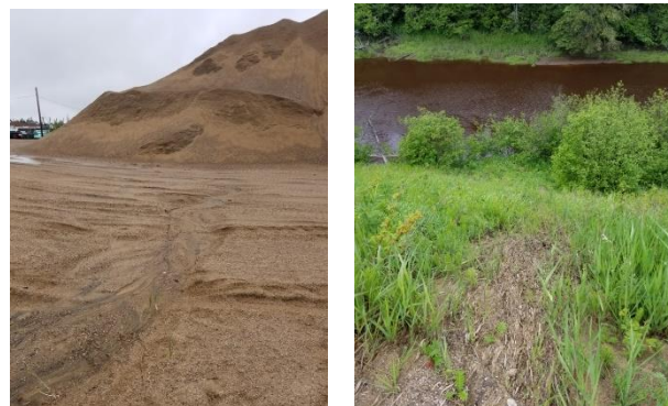
Figure 4: Présence de couloirs d'érosion et accumulation de sédiments dans le talus
