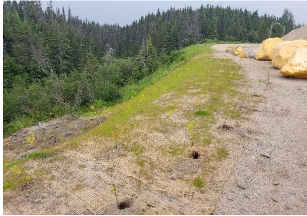
Figure 5: Blocs de roche à proximité de la crête du talus
